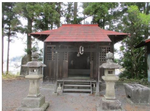
▲ 秋葉神社 壁・屋根破損状況
