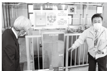
急速ろ過池（芝原浄水場）
