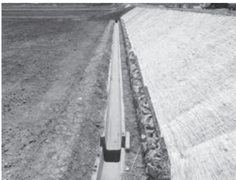
〈災害復旧現場〉
