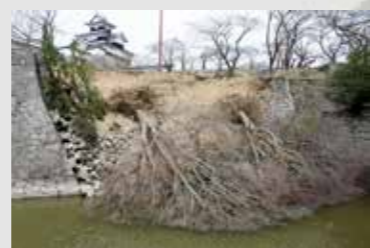
崩落した石垣上部の樹木
