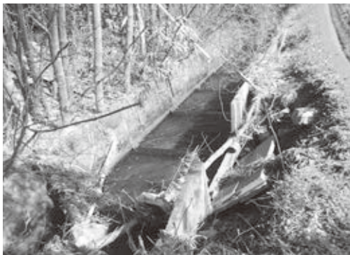
〈破損している幹線排水路〉
