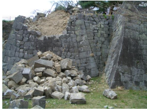
震災により崩落した石垣(月見櫓台)
