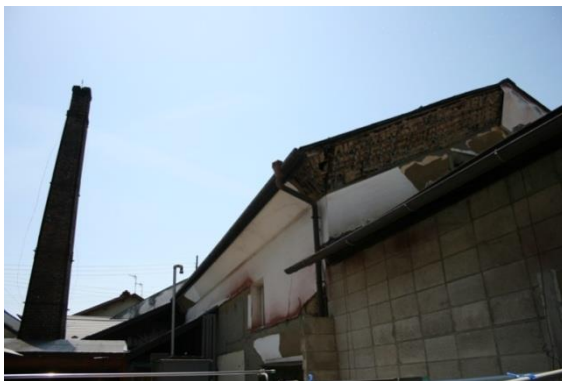
損傷が激しい葺
