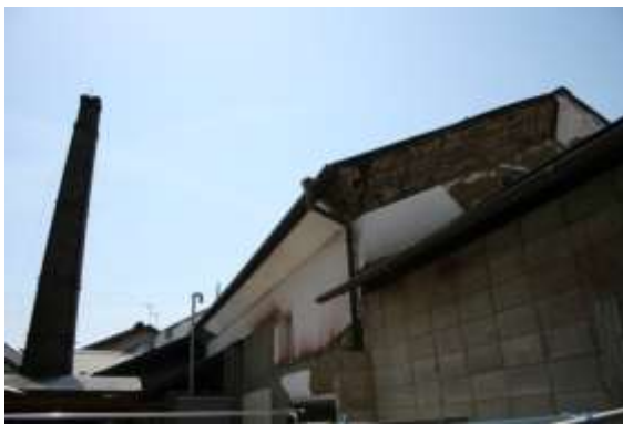
損傷が激しい蔵
