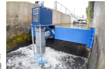
▶農業用水路に設置された小水力発電設備
