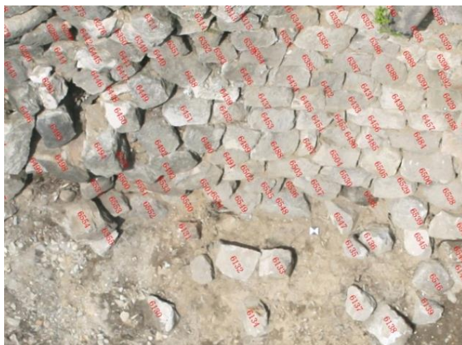
石垣崩落状況の記録
