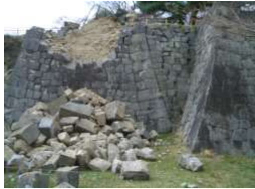
震災により崩落した石垣(月見櫓台)
