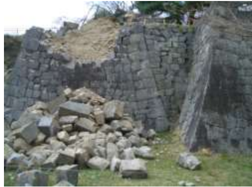
震災により崩落した石垣(月見櫓台)
