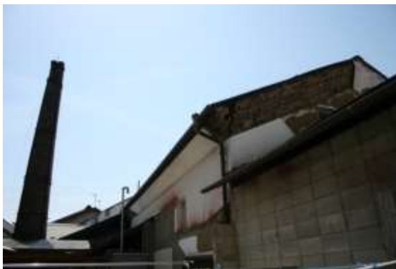
損傷が激しい蔵
