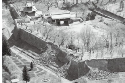
▶本丸北西側の石垣崩落状況
