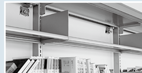
▲2階北側の本棚壁面固定部分の破損 本棚は、床にも固定ボルトがありますが、ほとんどが被害を受けました。
