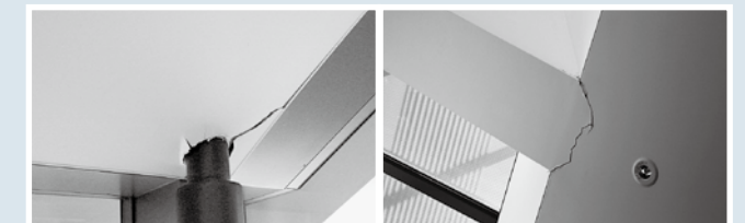
▲天井の仕上げ板が割れた様子
