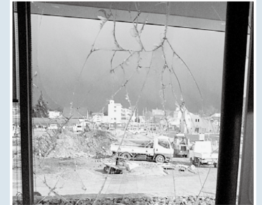
▲1階東側のガラス破損 二重ガラスの外側部分は、建物の外に割れ落ちました。落下防止フィルムが張られている内側部分には、大きな亀裂が入りました。
