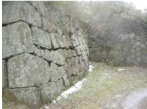
劣化が激しい小峰城の石垣
