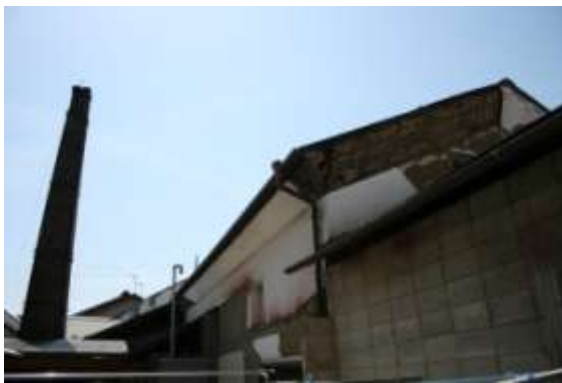
損傷が激しい蔵
