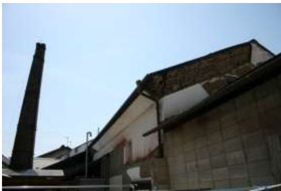
損傷が激しい蔵
