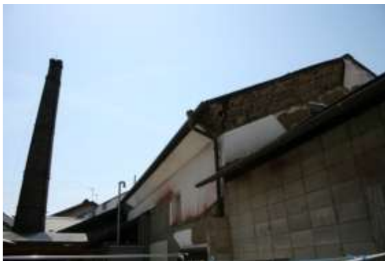
損傷が激しい蔵
