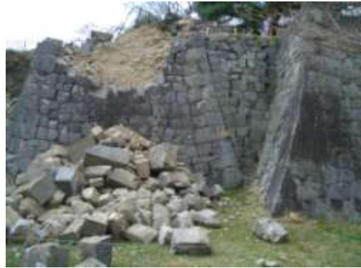
震災により崩落した石垣(月見櫓台)
