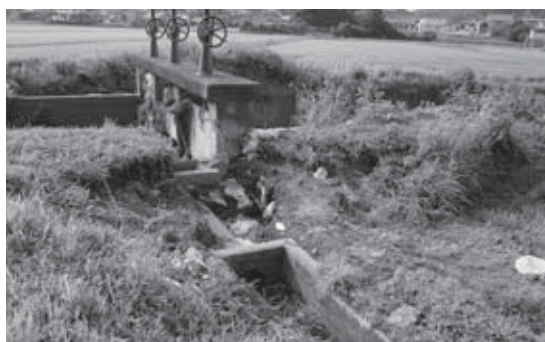
豪雨被害状況(白坂地内)
