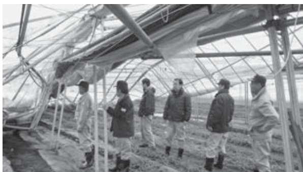
大雪により倒壊した農業用パイプハウス
